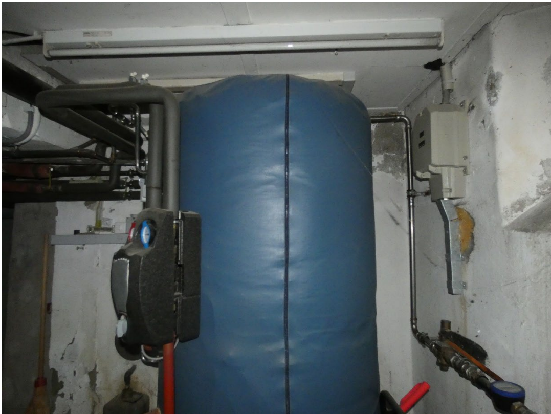
Haustechnik im Keller
