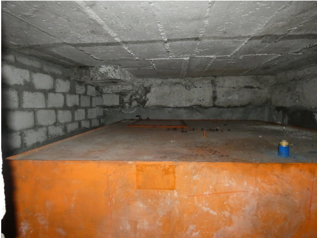
Tankraum im Keller
