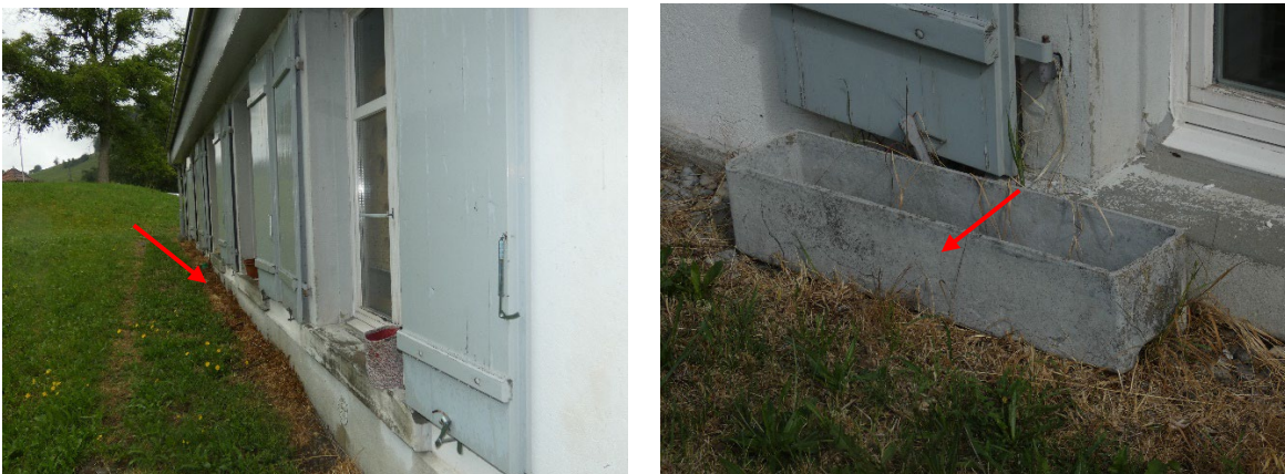
Abbildung 34 + 35: Links: Angeschüttetes Erdreich am Anbau; rechts: asbestverdächtige Blumenkiste.
