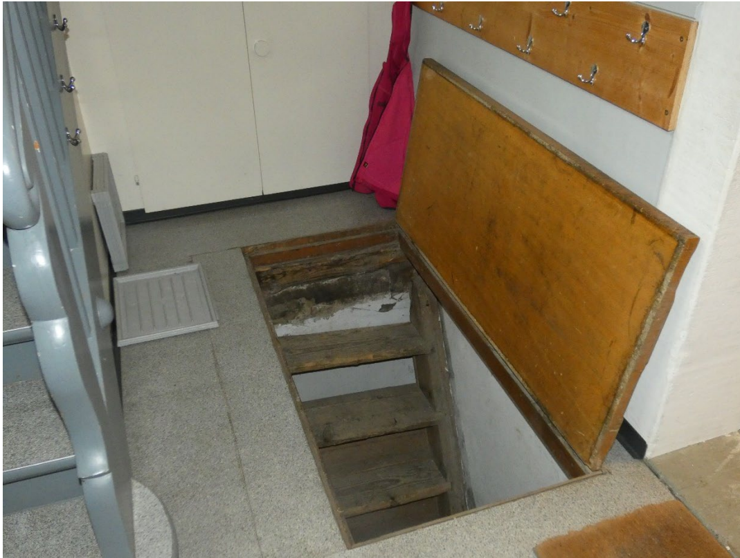
Abgang in Keller (Luke)
