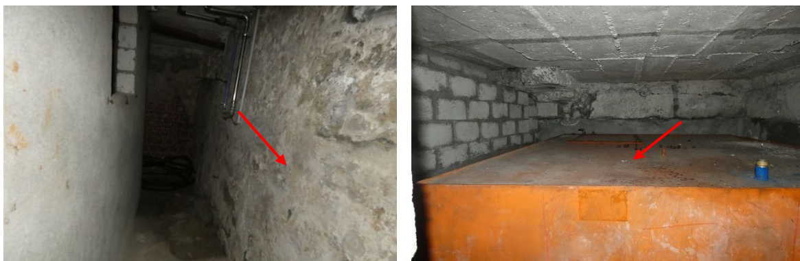
Abbildung 16 + 17: Links: Feuchtebelastete Wände im Keller, rechts: Ehemaliger Öltank.
