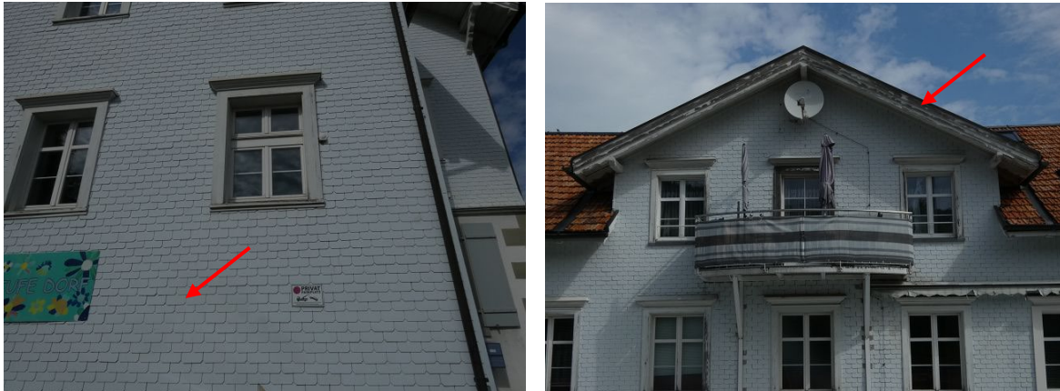
Abbildung 18 + 19: Links: Faserzementschindelung der Fassade; rechts: rückwärtige Fassade mit abgewitterten Ortbrettern.
