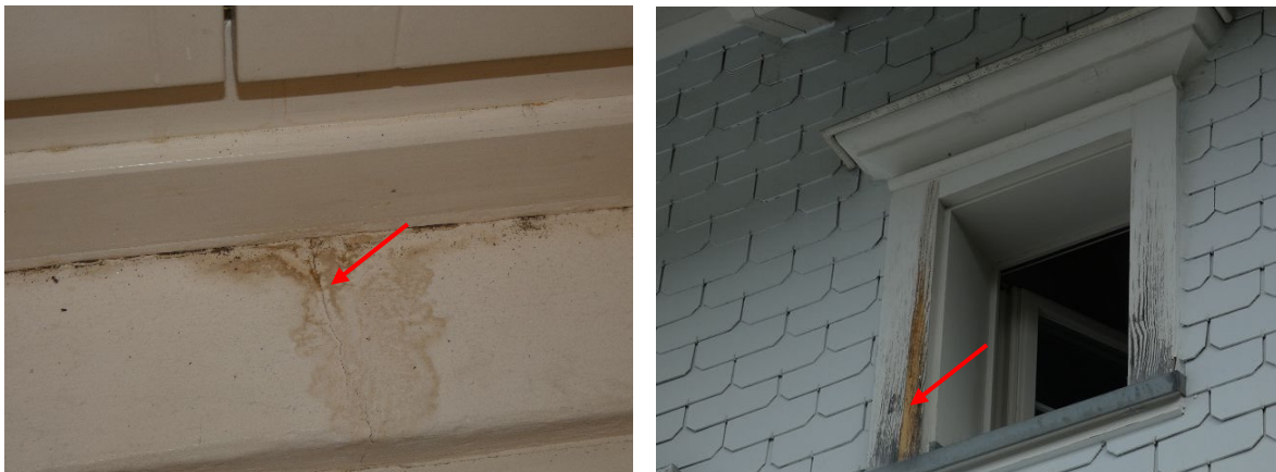
Abbildung 20 + 21: Links: Undichter Einbau neuer Fenster; rechts: abgewitterte Fensterfutter aussen.
