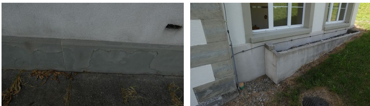
Abbildung 14 + 15: Links: Brüchiger Sandsteinsockel, rechts: Sanierungsversuch von Feuchtebelastung aus dem Erdreich.
